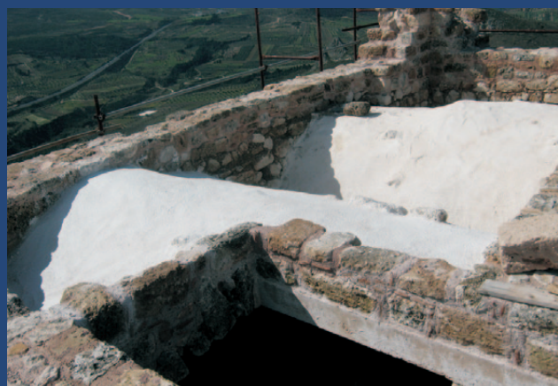
Εργασίες εξυγίανσης θολοδομίας και πλήρωσης κενών εξωραχίων Restoration works and filling gaps of the vaults extrados
